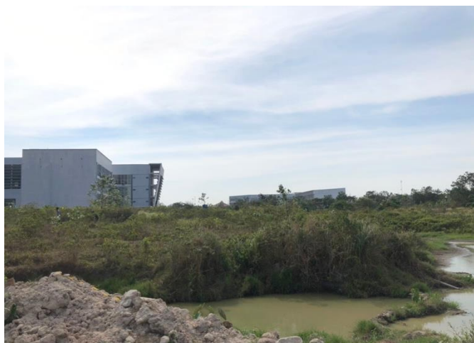
Gambar 3. 5 Genangan Air akibat kerusakan tanggul
